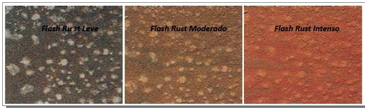
Figura 37 – Níveis de Flash Rust (D – WJ3)
